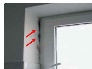
Condensações e desenvolvimento de fungos no lado interior
